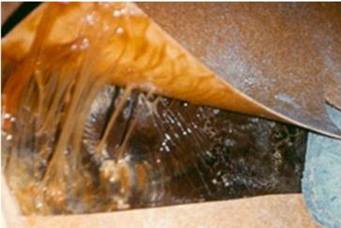
Figur 5. Lim som har förtvålats under en matta på betongbjälklag.
