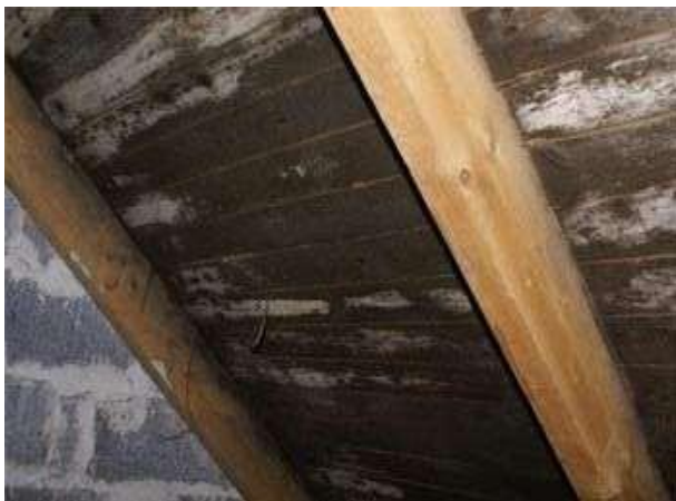
Figur 6. Kallvind drabbad av fukt- och mögelangrepp (Ljungby Fuktkontroll & Sanering AB 2020).
