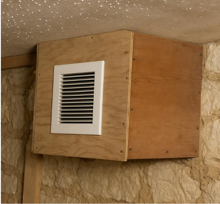
Figur 3; Exempel på en ventilation öppning.
