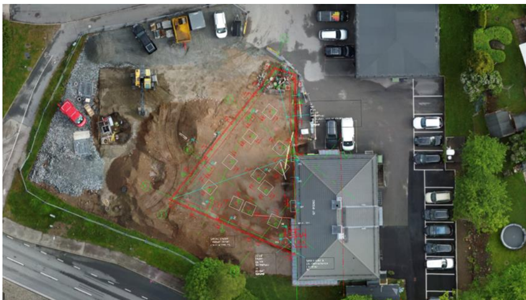
Figur 5. Skalenlig 2D-modell (ortofotografi) av ett byggprojekt där ritning för bottenplatta har lagts ovanpå. Ortofotot är utfört med drönbaserad fotogrammetri. Återgiven med tillåtelse från T3 Group
