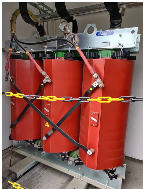
Figur 3.3. Bild på transformator T29 innanför skyddsörr.
